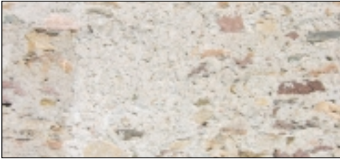
Enduit à pierre vue laissant apparaître certaines pierres partiellement (usure naturelle).
